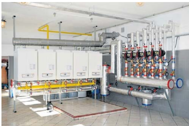
Nowa kotłownia w Szkole Podstawowej w Łososinie Dolnej
